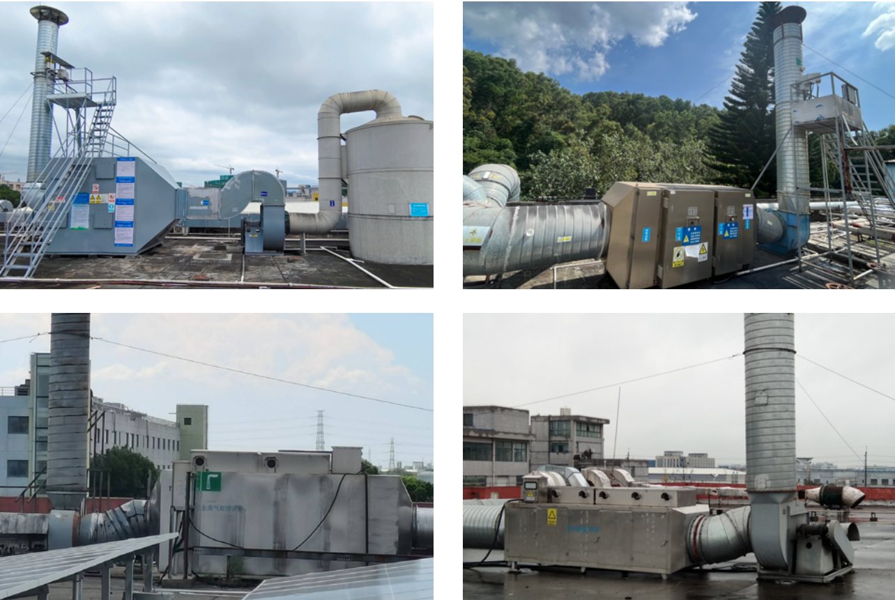
各公司廢氣處理設備
