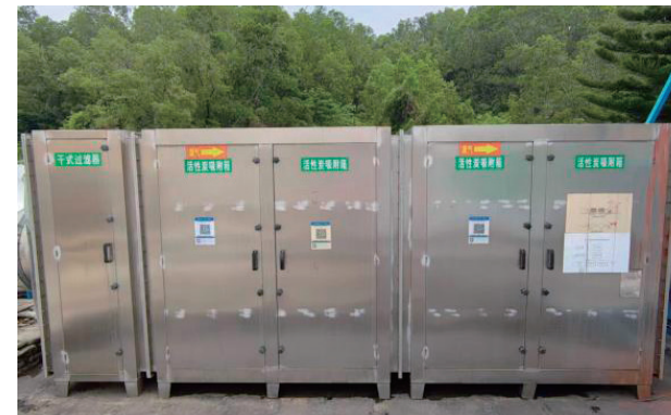
二級活性炭處理設備
